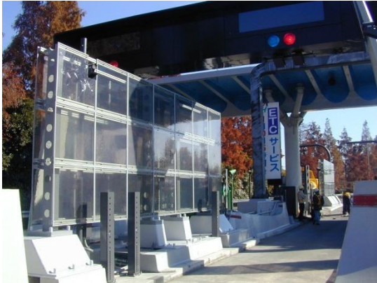
図 5・20 ETC における透明電波吸収体
